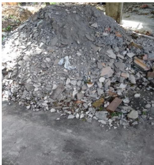
Figura1 –Resíduos de construção.
