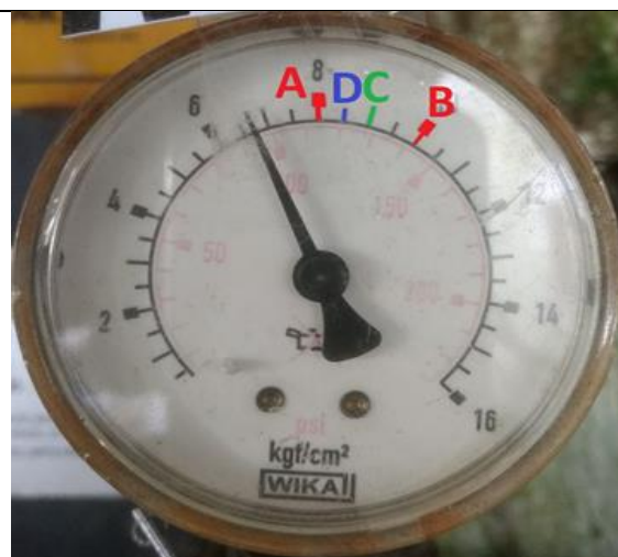
Figura 14: Manômetro M14 em detalhes (leitura válida para manômetro M15)
