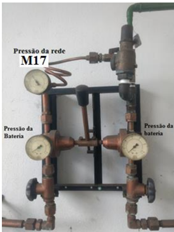
Figura 18: Manômetros da Central de suprimentos com cilindros de oxigênio medicinal do UNACON
