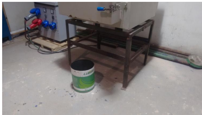
Figura 3.9 – Reservatório de óleo bem abaixo do forno.
